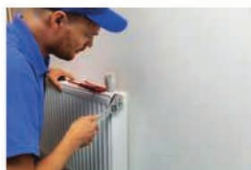
une panne de chauffage
