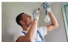
une panne électrique
